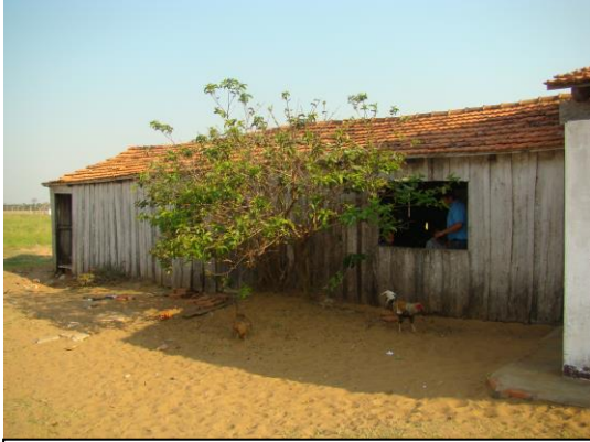
E. Básica 2352 "Alejandro Falcón" de Ayolas. Las débiles paredes de madera apenas pueden sostener el pesado techo de tejas.
